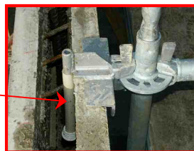
Bauseitiges Leerrohr mit Verschlussstopfen
